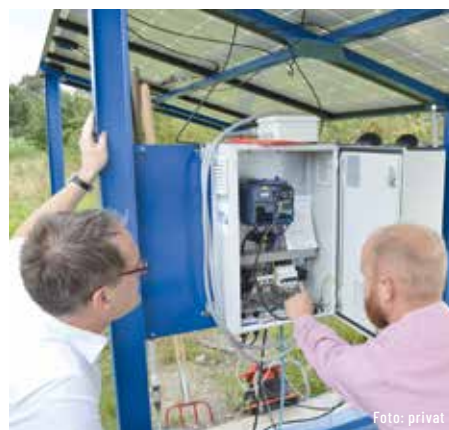
Die Automatisierung der Bewässerung erfordert die Abstimmung von Hard- und Software.
